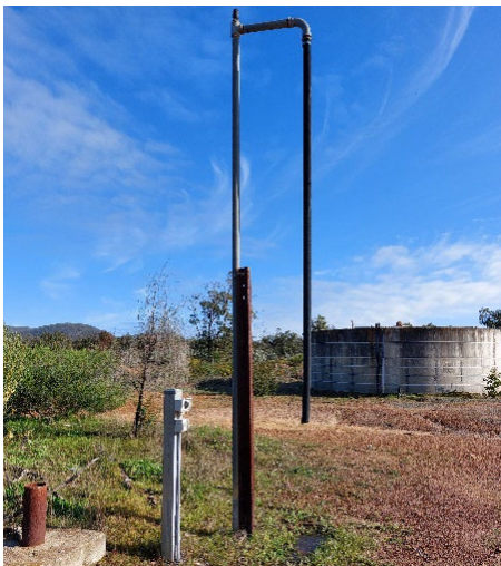
Gnowellen Road standpipe
