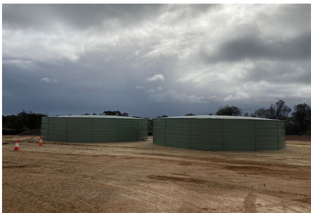
2 x 250 kL tanks
